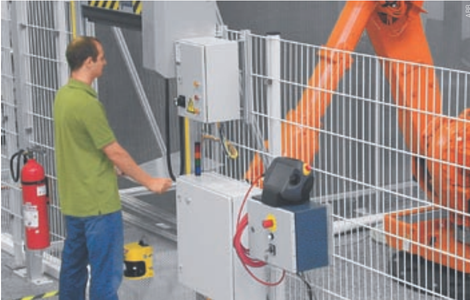
ABB nutzt bei ihren Roboterprodukten die neuesten technischen Entwicklungen für kostengünstigere Sicherheitseinrichtungen.
