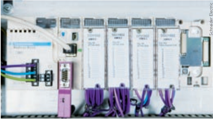
Die Automatisierungsplattform Modicon M340 von Schneider Electric ist das Kernstück des Stapelkranes.
