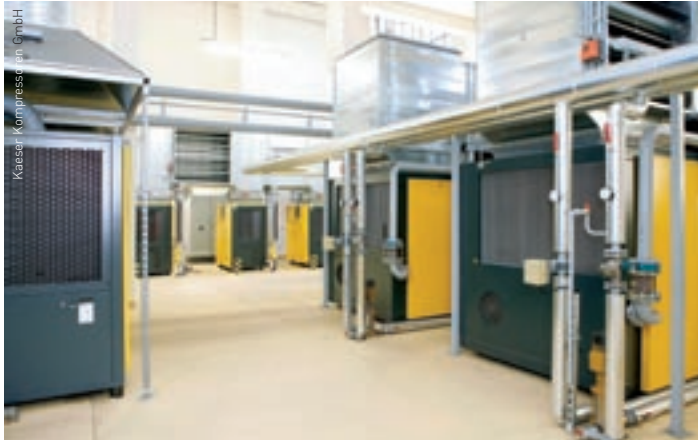
Moderne Druckluftstation mit luftgekühlten Schraubenkompressoren unterschiedlicher Grösse, übergeordnetem Druckluft-Managementsystem und Wärmerückgewinnung zum Erzeugen von Warmwasser.
