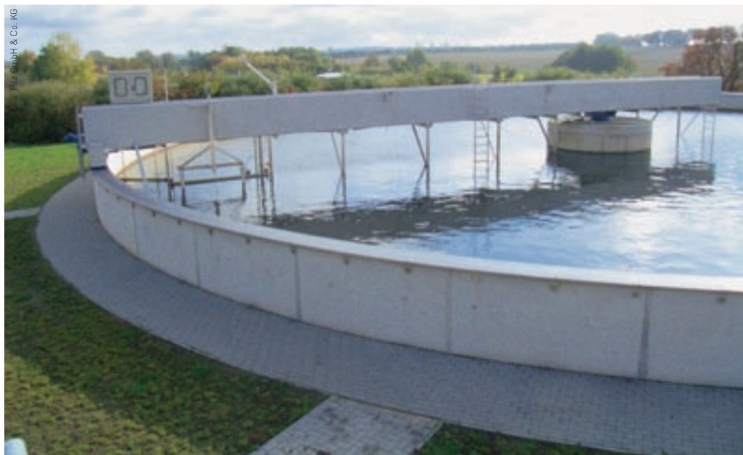
Die auf der Brücke des Nachklärbeckens mitfahrende Station sammelt Meldungen zu diversen Anlagenzuständen sowie eventuellen Störungen und Fehlern ein und überträgt diese per Funk an den 80 m entfernten Leitstand.
