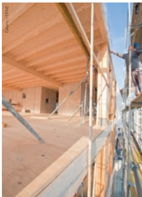
Die fixfertigen Fassaden-Elemente des Business Parcs, Reinach werden per Kran an die Montage-Position gebracht.
