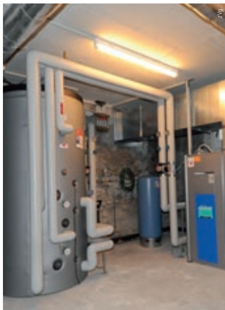
Luft-Wasser-Wärmepumpe in einem sanierten Zweifamilienhaus in Brig: Gerade beim Ersatz der alten Heizung sollte auch das Gebäudesystem betrachtet werden.
