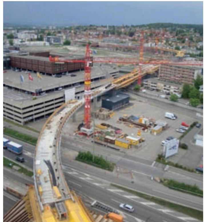
Beim Bahnhof Wallisellen überquert die Bahn in einem grossen Viadukt das SBB-Bahntrasse und die Autobahn A1. Bild: dsp Ingenieure & Planer AG, Greifensee
