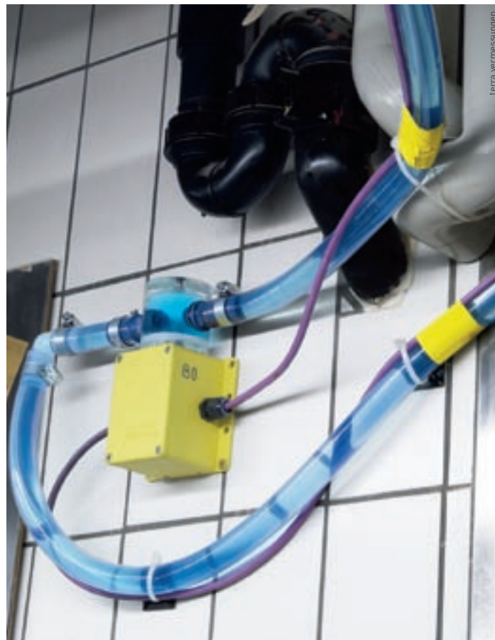
Für die Setzungsmessungen werden mehrheitlich Schlauchwaagen eingesetzt.
