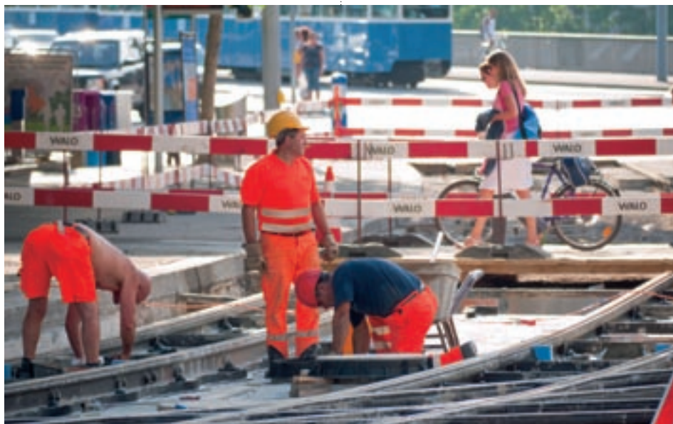
In der Schweiz müssen 300 km Tramschienen unterhalten werden; dies möglichst schnell, damit der Stadtverkehr nicht zu stark ins Stocken gerät. Bild: zvg
