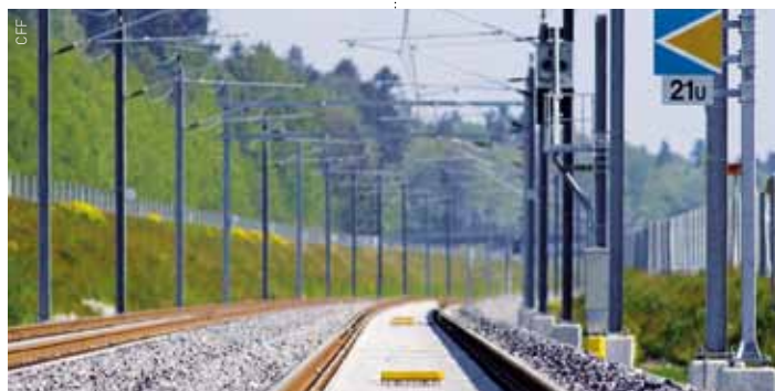
Le système ETCS avec ses balises (Eurobalisen) qui permettra le passage de trains circulant à 200 km/h toutes les deux minutes sur ces tronçons.
