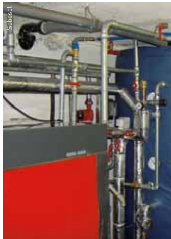
L'optimisation technique de la chaufferie.
